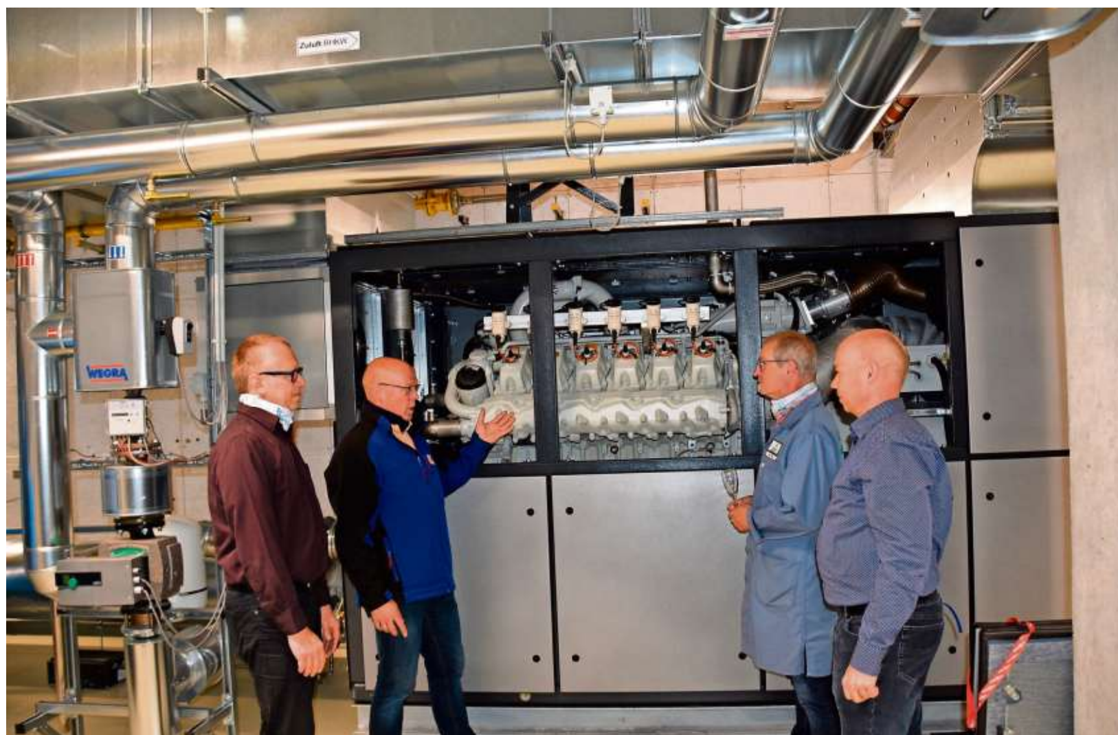
Am Dienstag wurde das neue Blockheizkraftwerk im Freizeitzentrum Rohrer Stirn offiziell eingeweiht. Im Bild (von links): Stadtwerke-Geschäftsführer Rolf Hagelstange, EAW-Vertriebsleiter Bernd Hebenstreit, Namensgeber Gert Then und der Technische Leiter bei den Stadtwerken, Thomas Zingel. Fotos: M. Hildebrand-Schönherr
